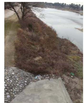
左岸、甲武橋下流部のゴミ
